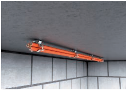
Gebündelte Kabelverlegung unter der Decke.
