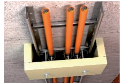
Montiertes Gehäuse der Zugentlastung an einer Steigeleiter
