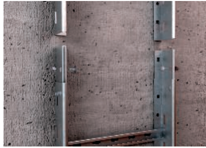
Stoßstellenverbindung mit verschraubtem Verbinder.
