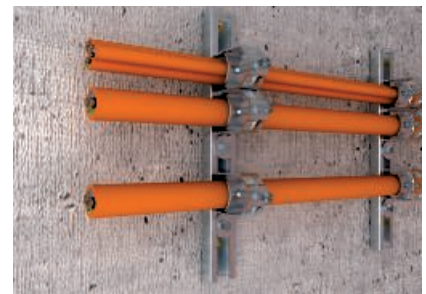
Gleitmutter unterhalb der Bügelschellen einsetzen, um so ein Abrutschen im Brandfall zu verhindern. Bei Abständen zwischen den Bügelschellen Gleitmutter unterhalb jeder Bügelschelle als Sicherung einsetzen
