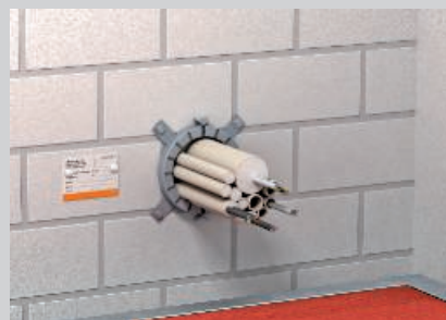
Gekennzeichnete Abschottung von Installationsrohrbündeln.
