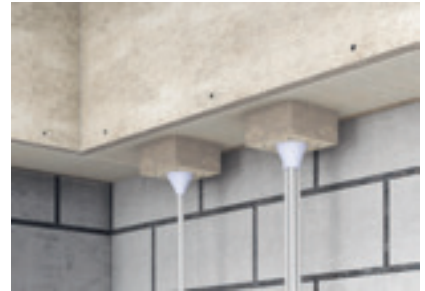
Montierter Brandschutzkanal mit Kabelausgängen
