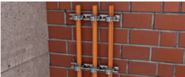
Senkrechte Montage der Kabel mit Bügelschellen an der Wand.
