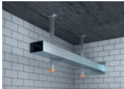
Abgehängte Montage auf Kabeltrag-system
